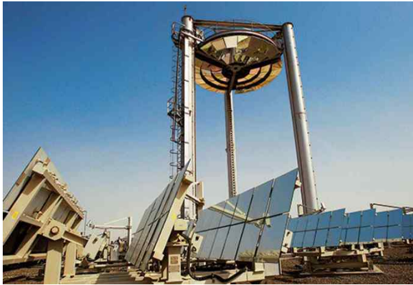
Beam-Down Tower 발전시설
